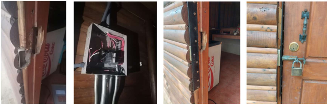
La reparación de la puerta se realizó con materiales existentes. El costo de cada breacker ronda los ₡ 8 000,00 (pendiente de compra).
